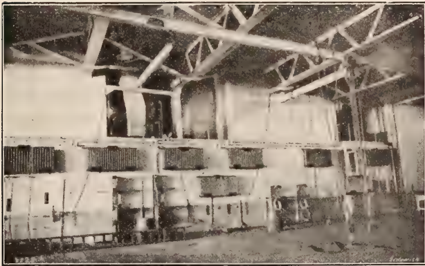
Aménagement intérieur du hangar avec radiateurs, supports de torpilles, etc..
